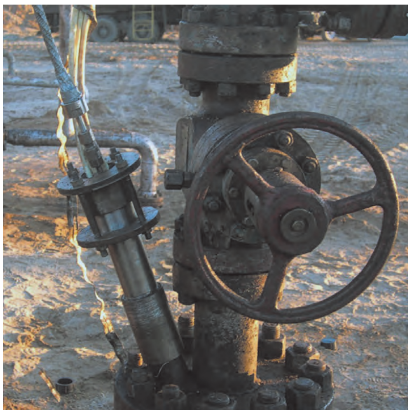
Рис. 7.9. Ввод капиллярной трубки совместно с силовым кабелем УЭЦН
