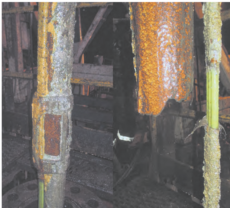
Рис. 7.5. Скважина А. Слева – отложения ИСО на наружной поверхности НКТ; справа – коррозия наружной поверхности НКТ под отложениями ИСО в месте обрыва подвески (глубина 2832 м), отложения ИСО на броне кабеля, коррозия брони кабеля под отложениями ИСО. Западно-Салымское месторождение, Нефтеюганский район, 2016 г.
