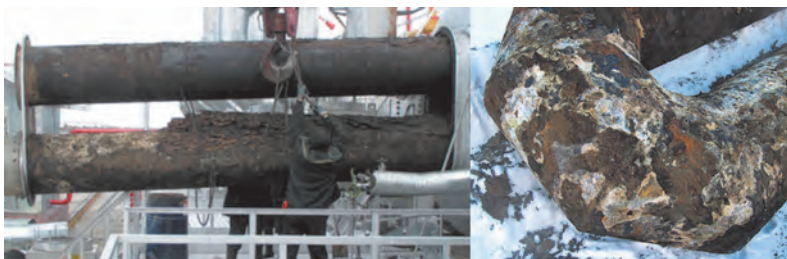
Рис. 1.20. Солеотложения на жаровой трубе сепаратора-подогревателя. Когалымское месторождение (г. Когалым), 2005 г. Снижение производительности аппарата, выход из строя жаровых труб. Состав отложений (% мас.): \text{CaCO}_3 – 72,8; \text{MgCO}_3 – 10,3; \text{FeCO}_3 + оксиды железа – 9,9; песок – 7
