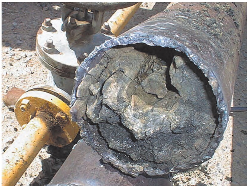
Рис. 1.22. Минеральные отложения в трубопроводе \varnothing 159 \times 8 мм подтоварной воды от сепаратора-подогревателя. Одно из месторождений Кумкольской группы (Казахстан), 2002 г. Состав отложений: BaSO_4 ; CaCO_3 ; CaSO_4 ; MgCO_3 ; SrSO_4 , песок, соединения железа
