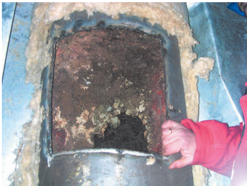
Рис. 1.24. Минеральные отложения в трубопроводе низкого давления системы ППД. Тэдинское месторождение (Ненецкий автономный округ, Тимано-Печора), 2004 г. Уменьшение внутреннего диаметра трубопровода. Состав отложений: песок, глина, оксиды железа, \text{CaCO}_3 , \text{CaSO}_4
