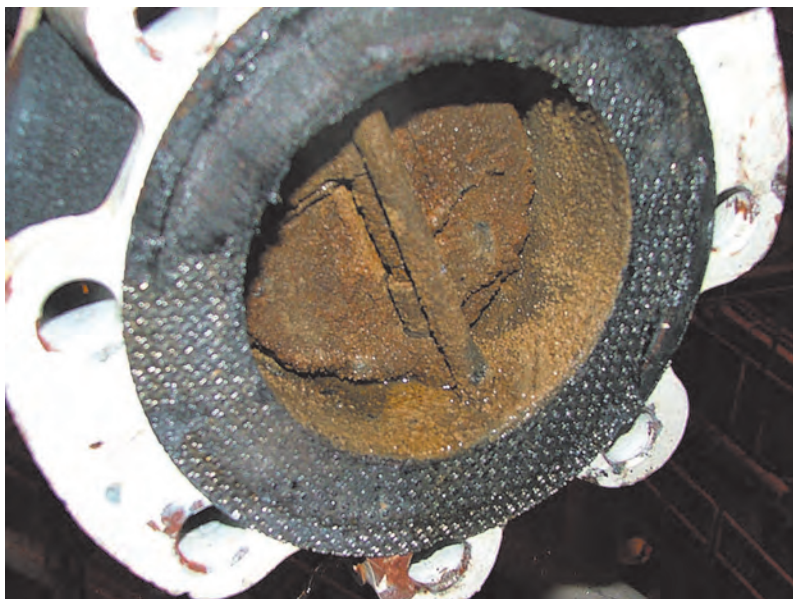
Рис. 1.27. Солеотложения на задвижке трубопровода системы ППД морской добывающей платформы Пильтун-Астохская А. Пильтун-Астохское месторождение (о. Сахалин, шельф), 2012 г. Состав отложений (% мас.): \text{CaCO}_3 – 57,2; \text{CaSO}_4 – 6,1; \text{BaSO}_4 – 11,2; соединения железа – 7,8; другое – 17,7
