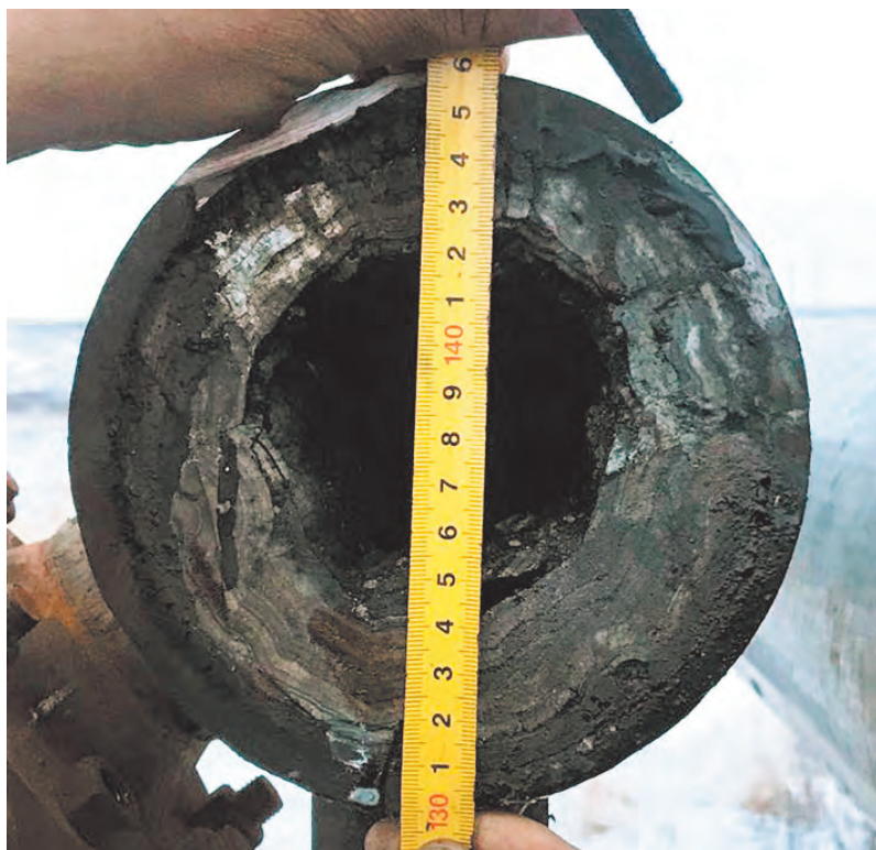
Рис. 1.15. Солеотложения в трубопроводе ССН \varnothing 159 \times 7 мм. Лекхарьягинское месторождение, 2018 г. Уменьшение внутреннего диаметра трубопровода (внутренний диаметр уменьшился на 46,7 %, площадь проходного сечения – на 71,6 %), увеличение перепада давления на участке длиной 2654 м. Состав отложений (% мас.): \text{CaSO}_4 – 90; другое ( \text{CaCO}_3 , \text{FeCO}_3 + оксиды железа, песок) – 10
