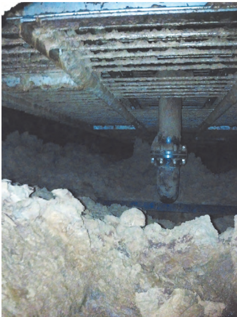
Рис. 1.17. Отложения в электродегидраторе морской добывающей платформы ПА-Б. Пильтун-Астохское месторождение (о. Сахалин, шельф), 2016 г. Уменьшение рабочего объема электродегидратора на ~ 20 %. Состав отложений (% мас.): \text{CaCO}_3 – 42; другое (песок, соединения железа, полимеры из буровых растворов) – 56
