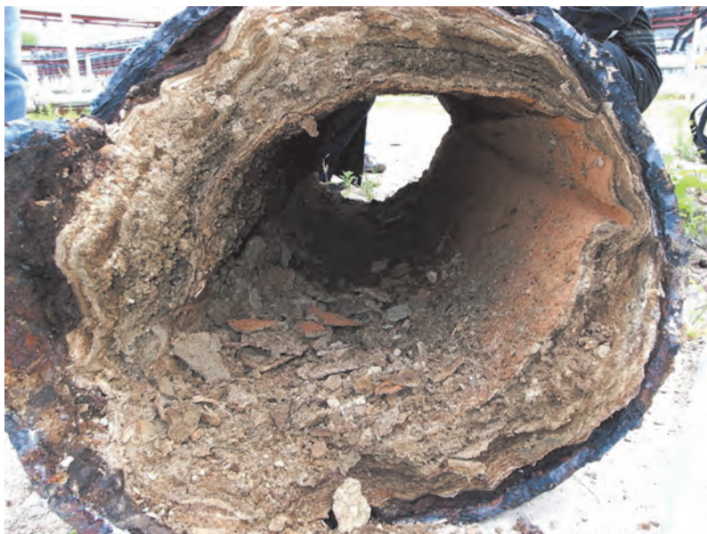
Рис. 1.23. Минеральные отложения в трубопроводе низкого давления системы ППД. Приобское месторождение (Тюменская область, Ханты-Мансийский автономный округ), 2009 г. Уменьшение внутреннего диаметра трубопровода. Толщина отложений от 45 до 60 мм. Состав отложений: песок, глина, оксиды железа и \text{FeCO}_3 , \text{CaCO}_3
