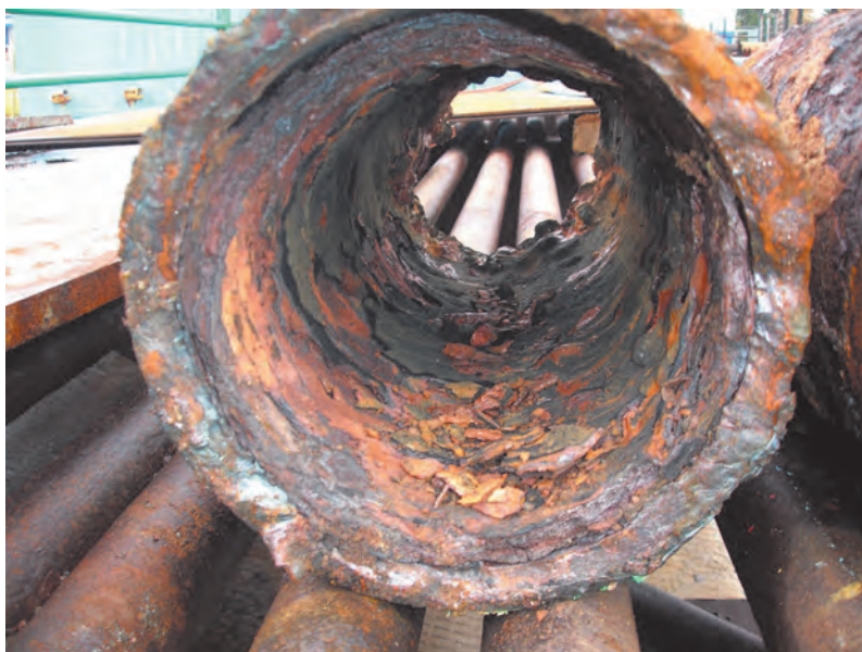
Рис. 1.25. Минеральные отложения в трубопроводе высокого давления системы ППД. Самотлорское месторождение (г. Нижневартовск), 2007 г. Уменьшение внутреннего диаметра трубопровода (внутренний диаметр уменьшился на 20 %, площадь проходного сечения – на 38 %). Состав отложений (% мас.): (\text{Ca}, \text{Mg})\text{CO}_3 – 5,1; \text{FeCO}_3 + оксиды железа – 71,1; песок, глина – 23,8
